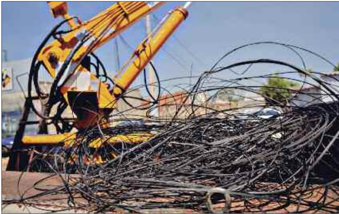
Fiação elétrica irregular em Anápolis
